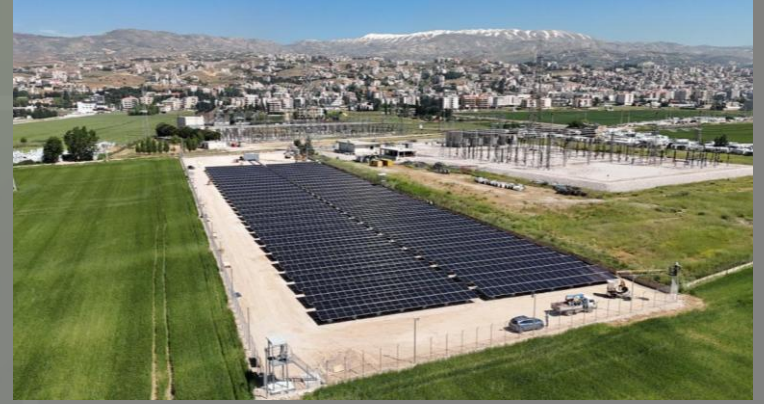
Electricité de Zahle 1.67 MWp
