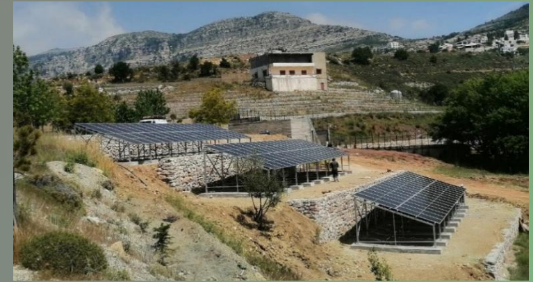
Ehden 135 55 kWp + 123 kWh
