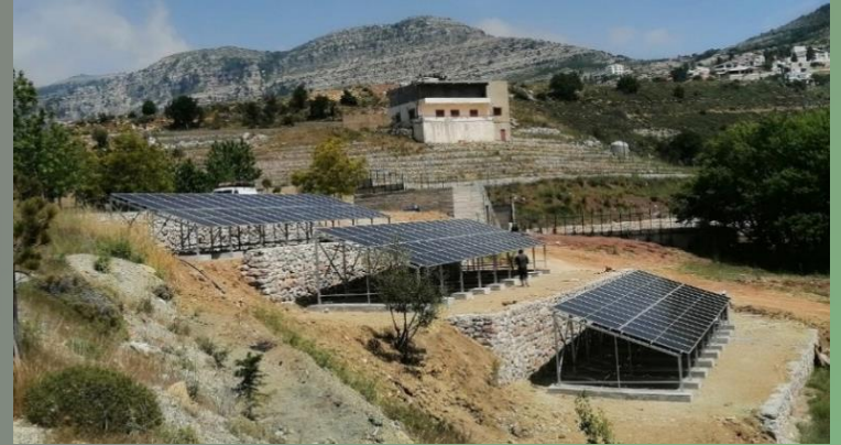
Ehden 135 55 kWp + 123 kWh
